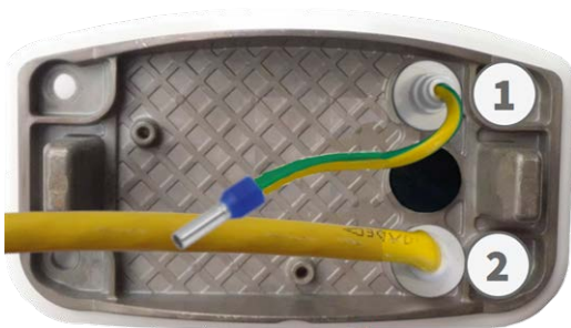
Abb. 49: Montageplatte mit Masseleitung und Netzkabel
