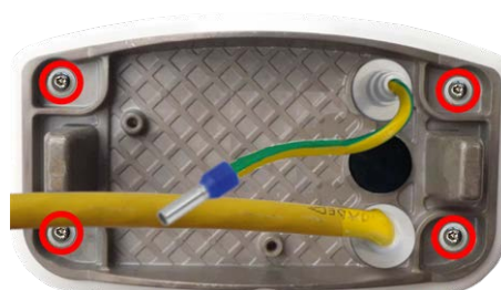
Fig. 51: Instalado y listo para Connector Box LSA
