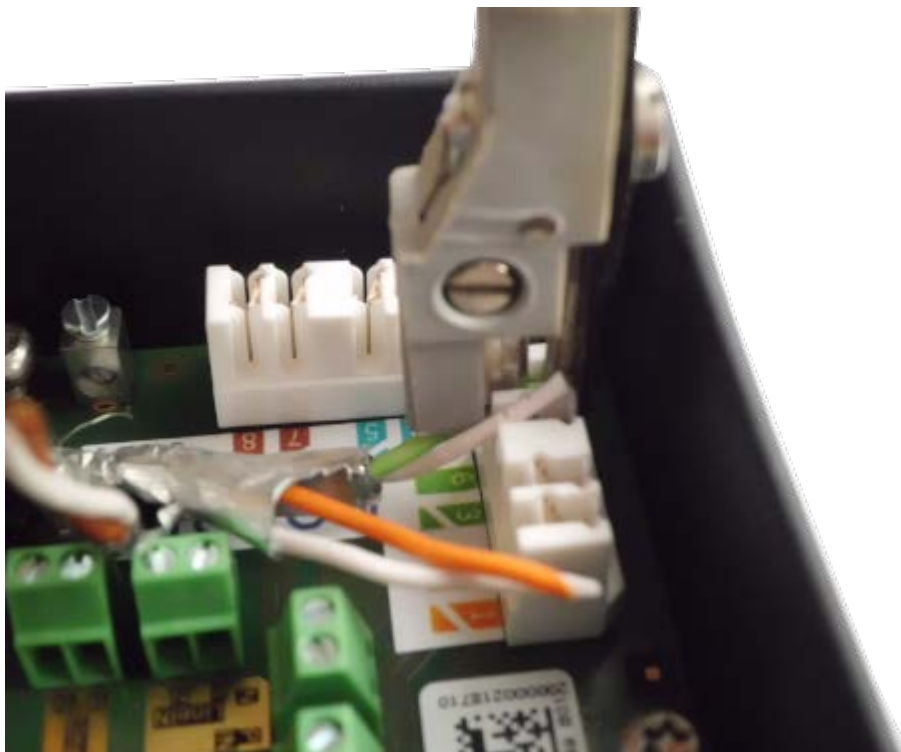
Fig. 63: Cables de red conectados mediante la herramienta LSA+/Krone
