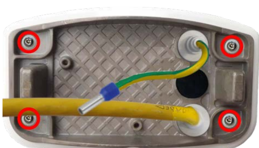
Fig. 58: Plaque de montage avec fil de terre et câble réseau
