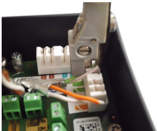
Fig. 59: Fili del cavo di rete collegati mediante lo strumento LSA+/Krone
