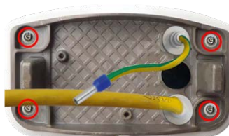
Abb. 18: Installiert und bereit für Anschlussdose LSA
