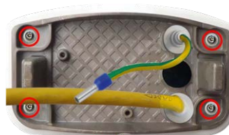
Fig. 12: Instalado y listo para Caja de conexiones LSA
