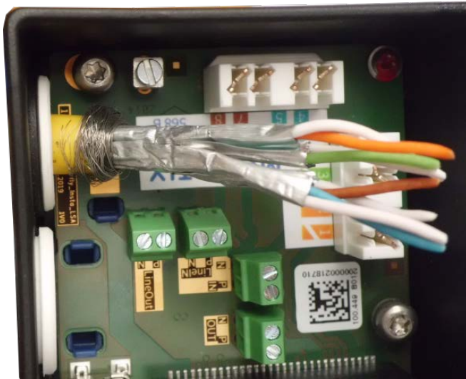
Abb. 24: Netzkabel eingesteckt, Stecker sitzt richtig
