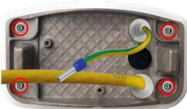
Abb. 22: Montageplatte mit Erdungsleitung und Netzkabel
