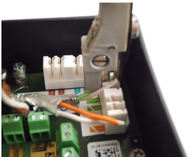
Fig. 27: Cables de red conectados mediante la herramienta LSA+/Krone
