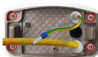
Abb. 13: Installiert und bereit für Anschlussdose LSA
