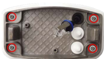
Abb. 6: Installiert und bereit für Anschlussdose RJ45
