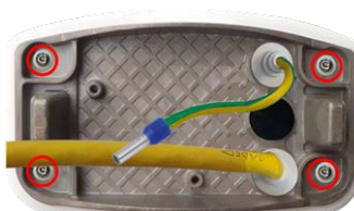
Abb. 7: Installiert und bereit für Anschlussdose LSA
