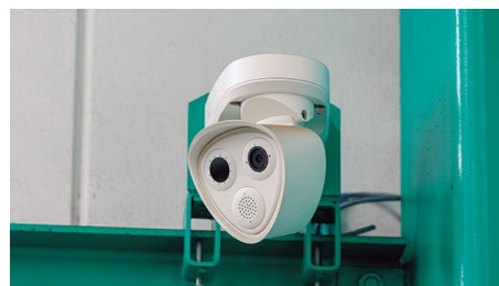
MOBOTIX M73 Wärmebildkamera, installiert in der Sammel- und Sortieranlage
