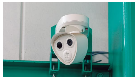
Cámara térmica MOBOTIX M73, instalada en la planta de recogida y clasificación
