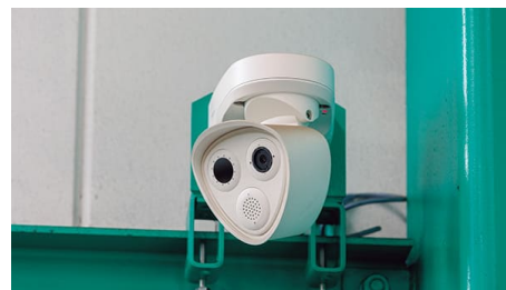
Telecamera termica MOBOTIX M73, installata presso l'impianto di raccolta e selezione
